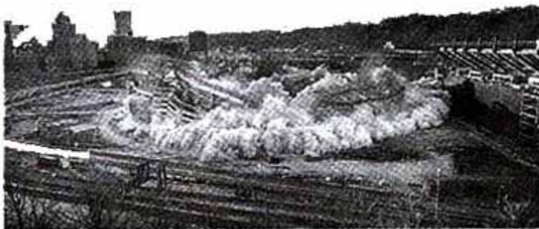
تصویر ۱- تخریب. ماخذ: (Pulaski & Hewitt, 2003)
